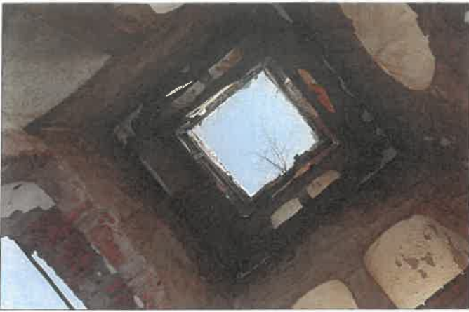
Průhled polozřícenou kostelní věží
